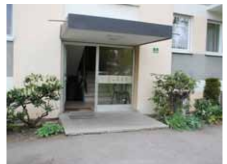
Eingangsbereich - nicht barrierefreie Zugänge zu den Wohnungen
